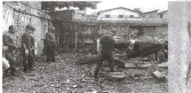
Operários iniciam a demolição do prédio atual onde será erguida uma nova estrutura do Mercado do Monte Castelo
